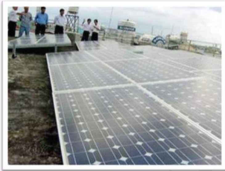
Hình: Tòa nhà của Tập đoàn Tuần Ân (Q.Bình Tân, TP.HCM), công suất 12.6kWp.
