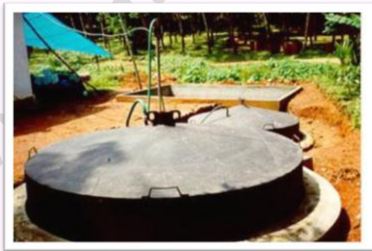
Hình: Hầm Biogas.
