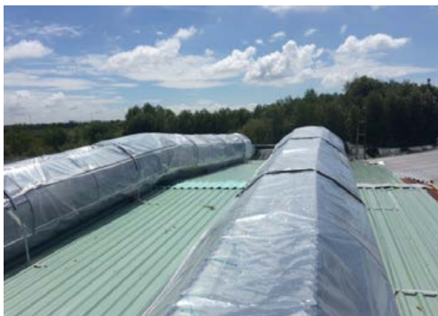
Ống thu năng lượng mặt trời được lắp trên mái nhà cung cấp nhiệt cho quá trình sấy
